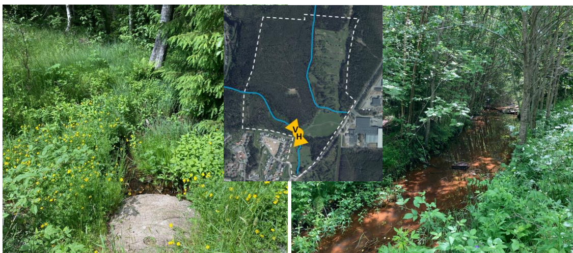
Figur 9: Vänster bild visar en större trumma i betong som leder vattnet från bäcken under en gångväg. Trumman är även fylld med makadam. Vänster bild visar den västra bäckens karaktär.
