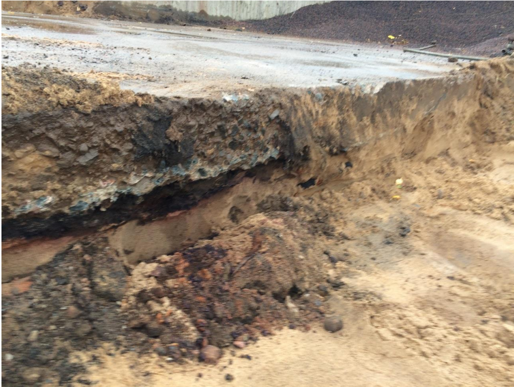
Svart skikt under betonficka
