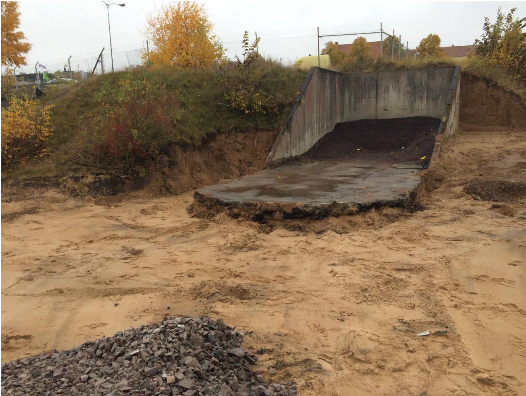
Betongficka i 5D och 5E
