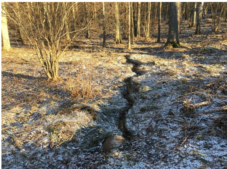
Figur 4 Befintlig trumma (400 BTG) ses i nederkant av bilden som avleder dagvattnet i vägdiket söder om Valhallavägen till naturmarksområde norr om vägen (Bild tagen vid platsbesök 2019-01-18).
