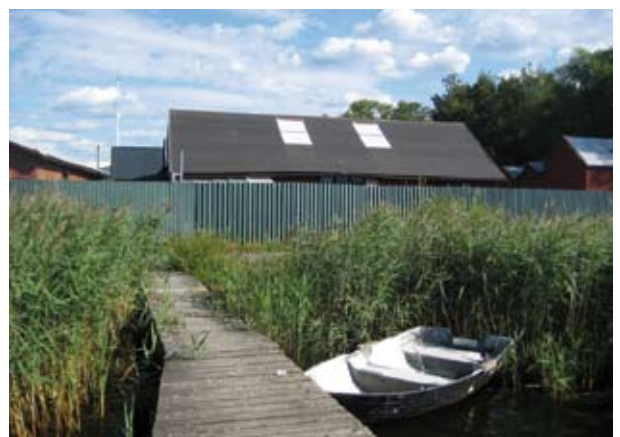
Brygga i dåligt skick och plank som skärmar av båthusmiljön
