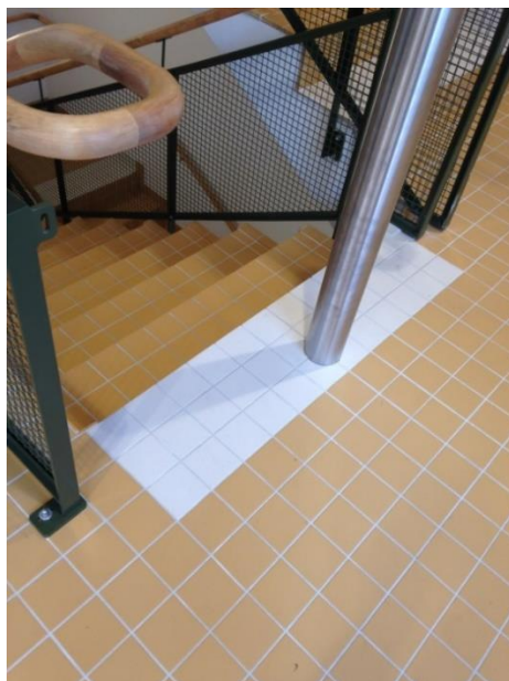
Trappstopp med kontrastfärgade trappor.
