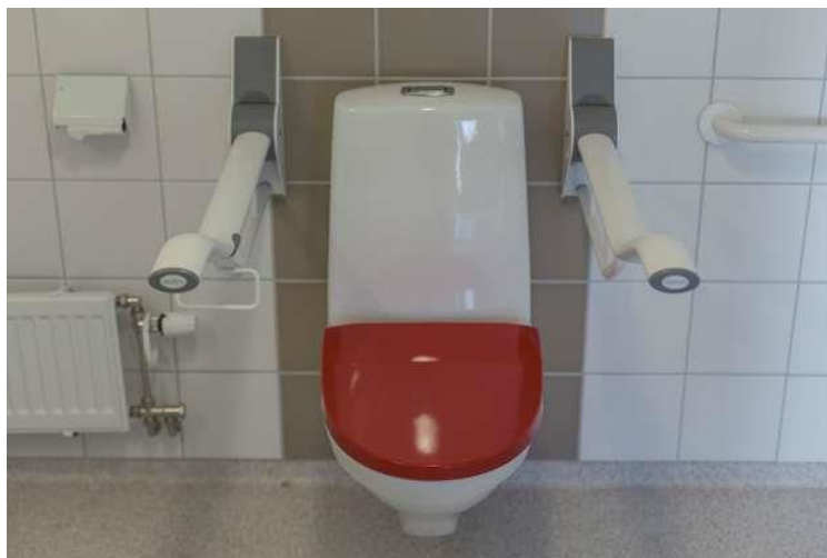
Kontrastfärgat kakel samt avvikande färg på wc sits.
