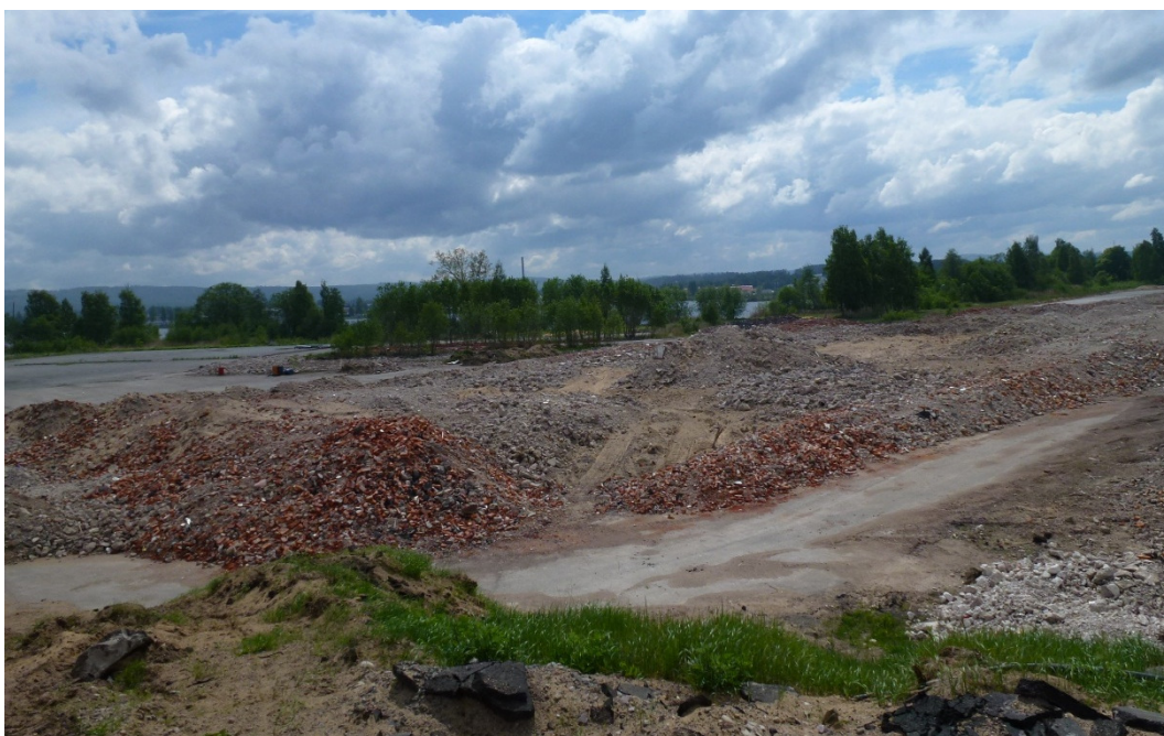
Foto 1 (2013-05-29) Högar med rivningsmaterial mitt i området, ca 1-2 m hög men vissa toppar är ca 3-4 m höga.
