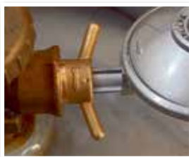
T.v. Gasolbehållare med monterad reducerventil 2
