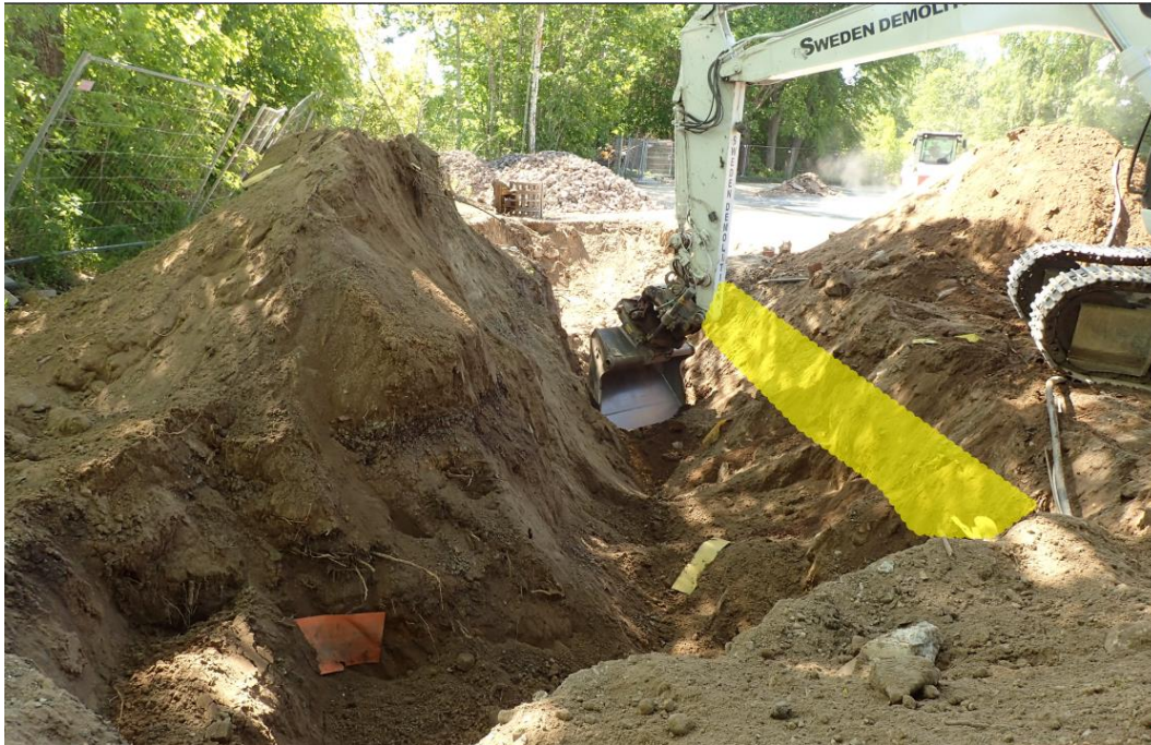
BILD 4 FÖRORENING AV ALIFATER I VÄSTRA SCHAKTVÄGGEN.
