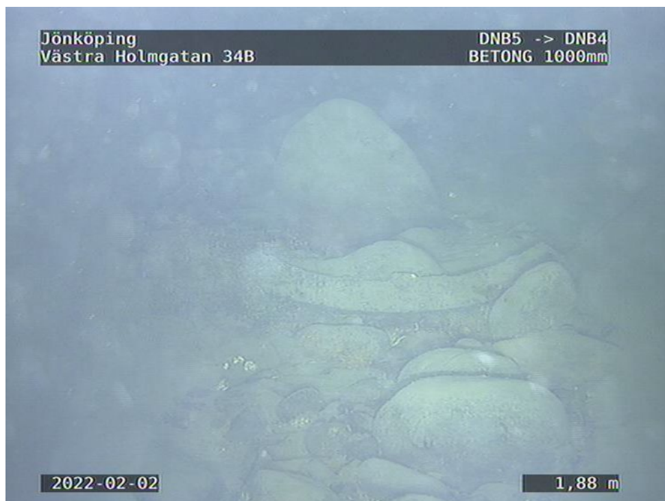
Figur 6 Foto invändigt intagsledningen cirka 2 meter väster om ("nedströms") brunn 5 som visar stenar med mera som utgör stopp för filmningen.
