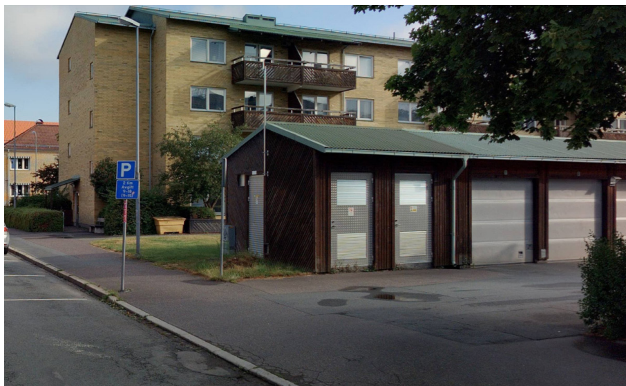
Figur 26. Fotot visar transformatorstationen på Union 17, till vänster.
