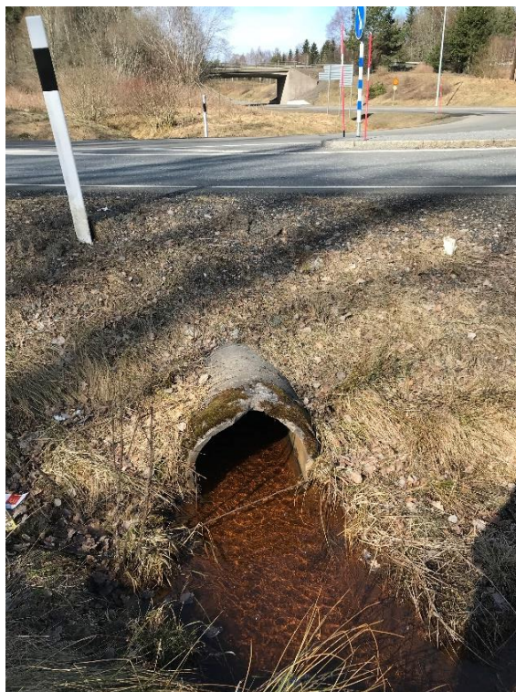
Figur 3-7: Ett av de rör där inkommande vatten från vägverkets dagvattenhantering går samman med dagvatten från planområdets västra delar.
