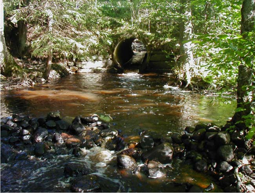
Figur 7. Strömnacken nedan trumman så som den såg ut innan åtgärd.
