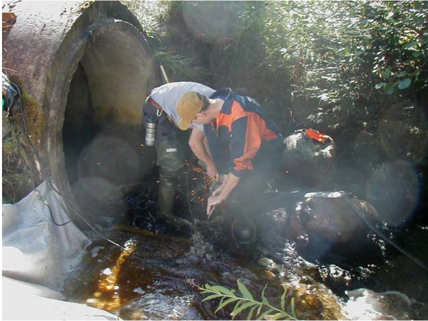
Figur 5. En galvad plåt borrar fast i betongplattan för att styra över vatten och skapa en högre vattensula på plattan. Höjden på plåten är endast ca 12 cm vilket gör att man inte orsakar någon nämnvärd dämning upp i trumman och att det vid högre flöden strömmar fritt rakt över plåten.
