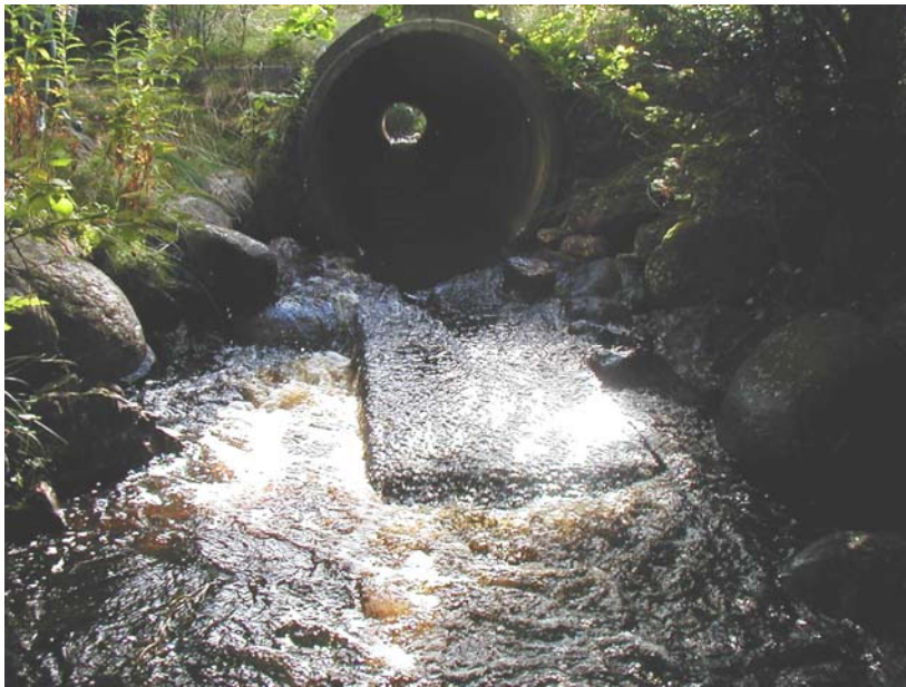
Figur 1. Den nedre vägtrumman under Nissastigen. Ett betongfundament ligger på nedströmssidan, vattenhastigheten är hög och vattendjupet litet, vilket gör det svårpasserbart för fisk.
