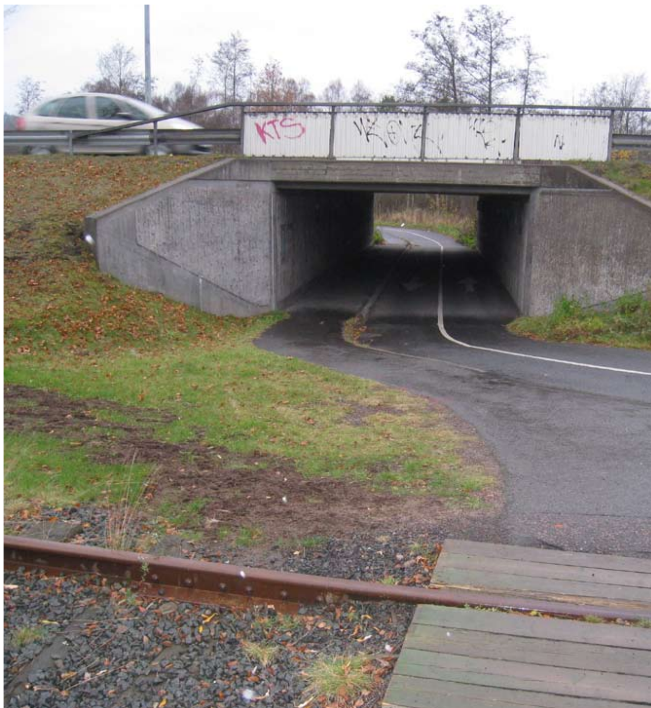
Tunnel under Jordbrovägen som saknar belysning.
