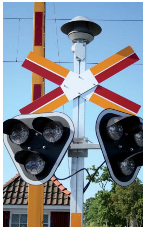
Banverket kontaktas vid arbete i närheten av spår och kontaktledning
