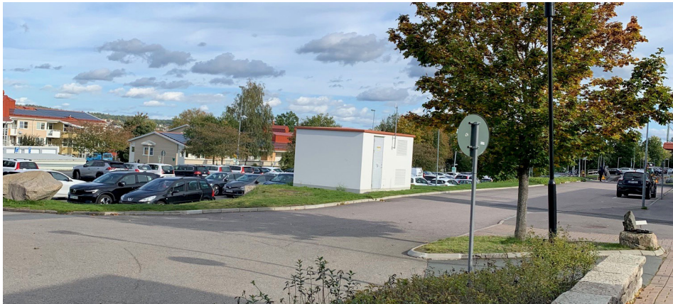
Bilden visar transformatorstationens placering inom området.
