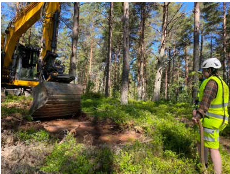
Figur 2. Arbetsbild, Emma och Gustav (i grävmaskinen) har påbörjat sökschaktningen. Foto: Anna Ödeén.
