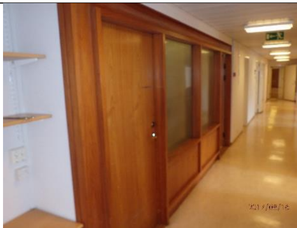
Träpartier mot trapphus, klinkerfix i trapphus med asbest , likt prov 18
