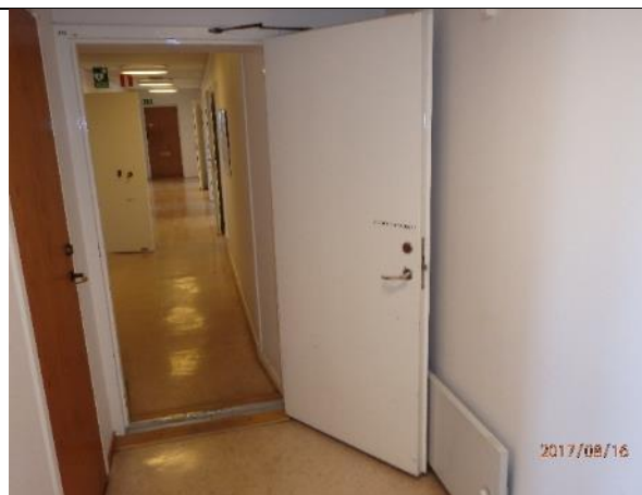
Ståldörr med asbest isolering
