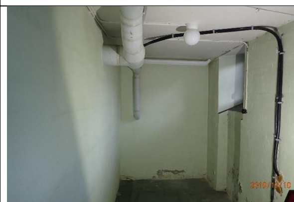
Ventilationskanal med ljust ventilationskitt asbest , inkommande kablar med olja
