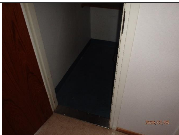
Städrum med asbest i matta, Städrum med asbest i matta, blå lättbetongväggar
