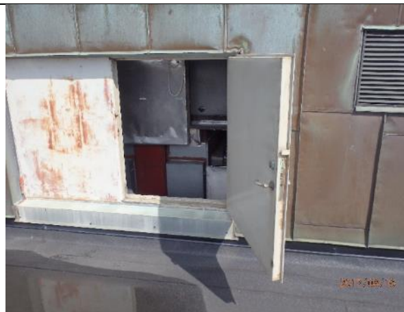
Dubbeldörr med isolering av asbest
