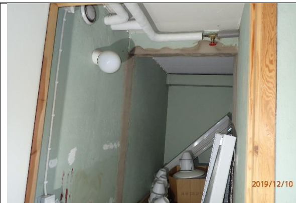
Asbestisolering i böjar, t-stycken och slut i källarförråd.
