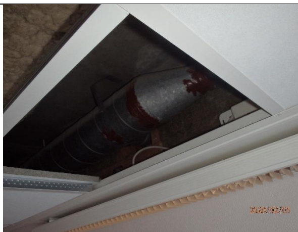
Ventilation likt prov 11 Rött ventkitt, asbest i prov
