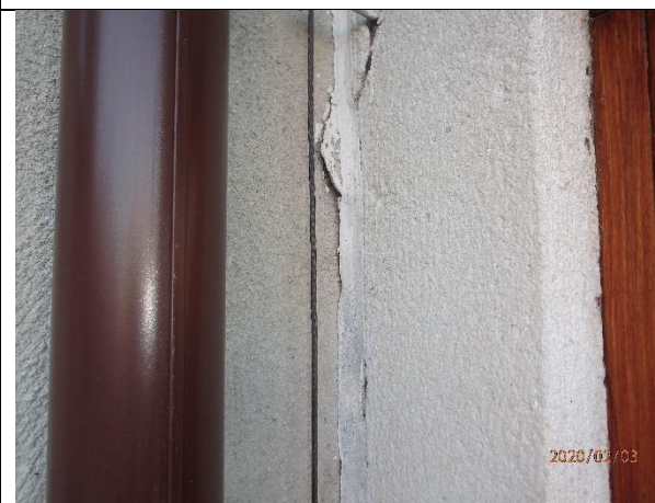
Prov 21 Fasadfog, asbest i prov
