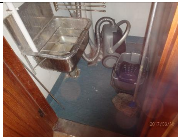
Städ och förråd, golvatta med asbest , lika som prov 8 som påvisade asbest
