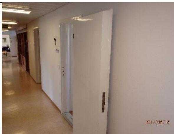
Arkivdörrar med asbest isolering
