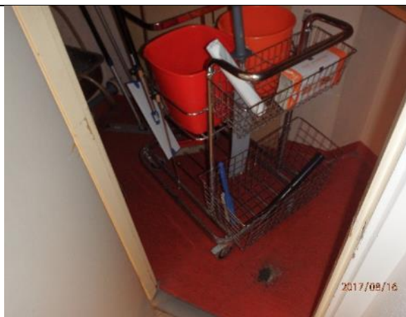
Städutrymme med röd golvmatta, asbest i matta
