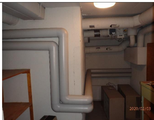
Rörinstallationer och blå lättbetongväggar
