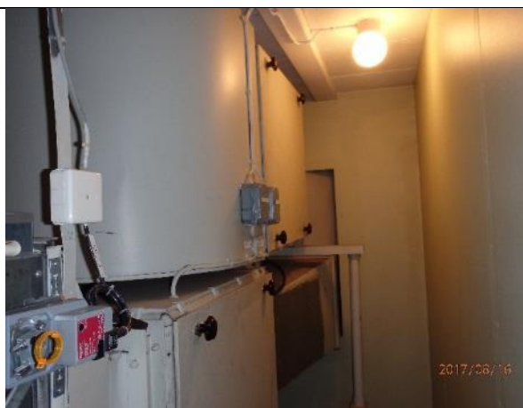
Fläktaggregat, isolerad intagskanal
