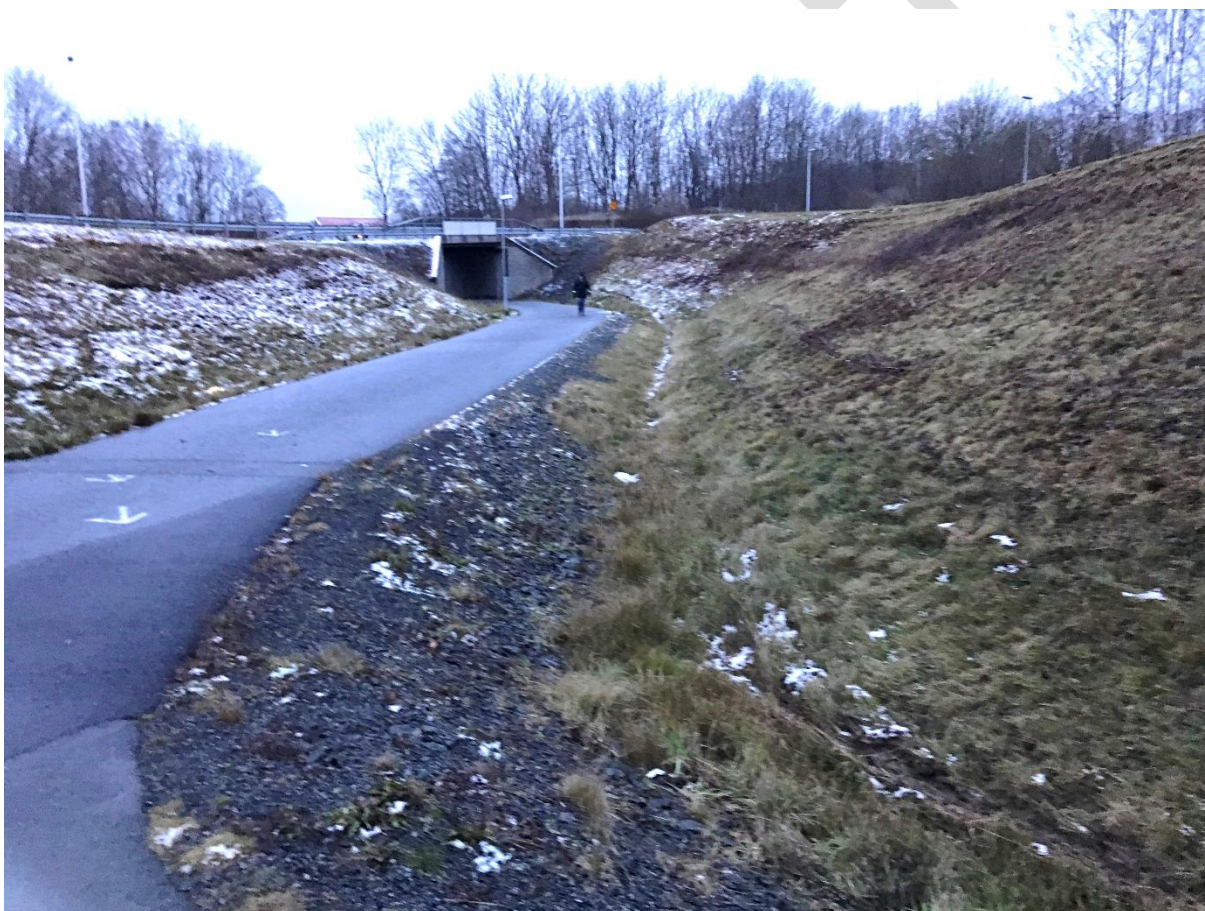
Figur 3-7: Svacka med gångtunnel utanför fastighetens sydöstra hörn vilken kan svämma över vid extrema regn.
